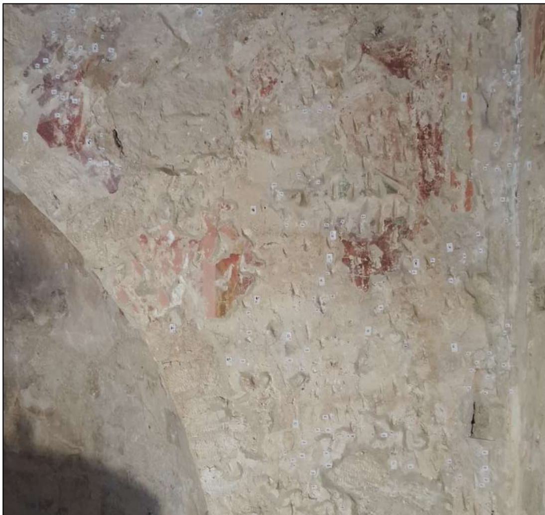
Slika 5. Primjer obilježavanja šupljih zona i točaka injiciranja; desna strana trijumfalnog luka
